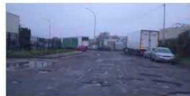
Chaussée dégradée Rue du Travy
