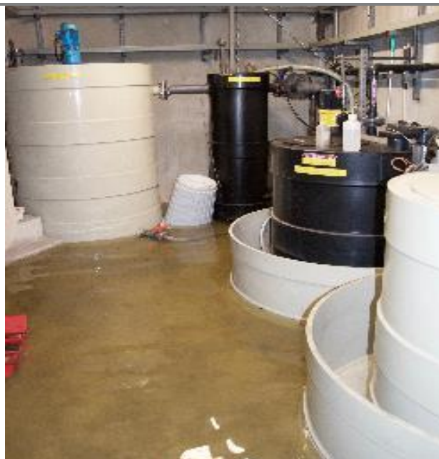
Inondation de juin 2016 – DEEA – Dammarie-les-Lys (source : Département 77)
