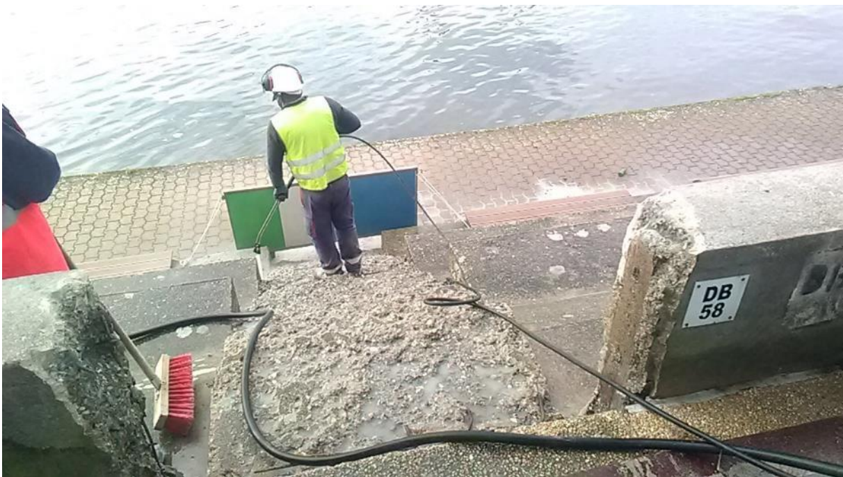
Quai Blanqui – Alfortville – condamnation d'une brèche (94) [2019] Copyright : CD94
