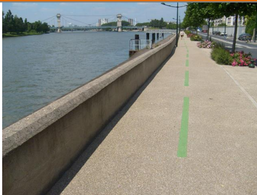
Murette anti-crue – Quai Jean-Baptiste Clément – Alfortville (94) - Copyright : CD94
