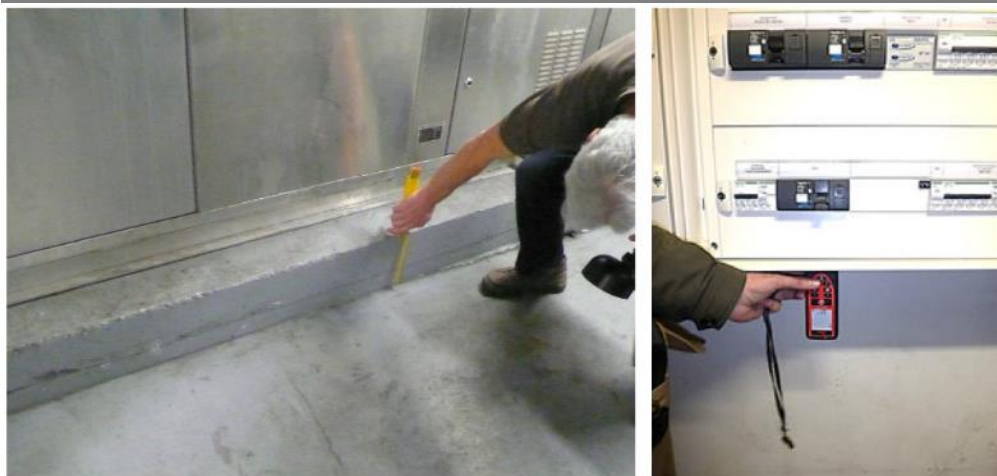
Repérage de la sur-élévation des équipements. Copyright : SUEZ
