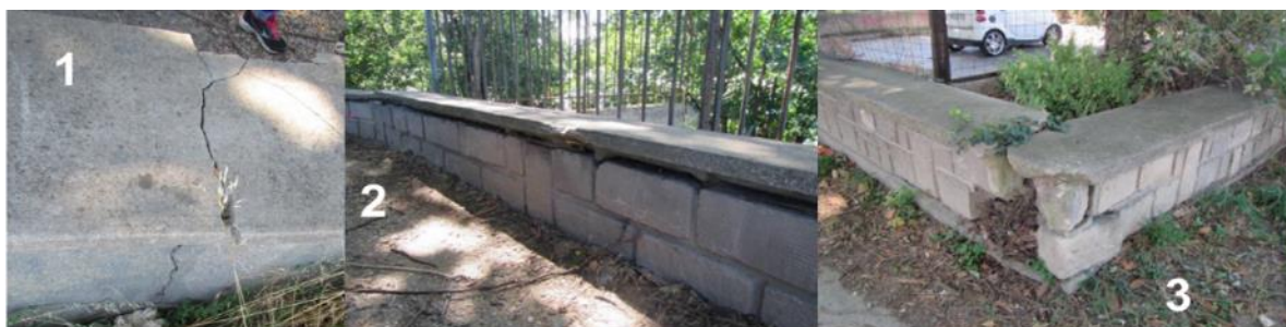
1-Fissure traversante et décalage du couronnement de mur 2 & 3 déplacements et signes de déstructuration
